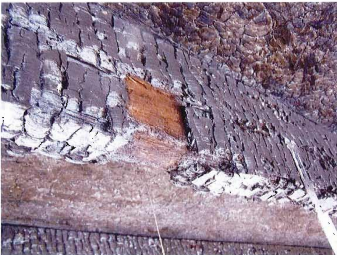
Vue de détail de la carbonisation d'une solive en partie courante après la réalisation de l'essai
