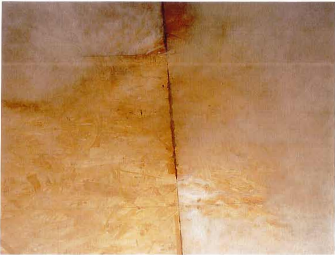
Vue de détail de la face non exposée au niveau du joint transversal central à 35 minutes d'essai
