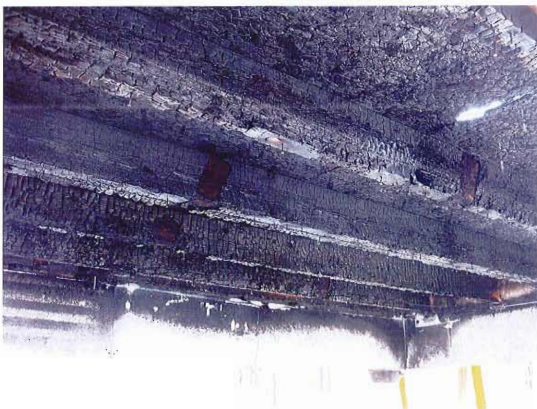
Vues de la face exposée après la réalisation de l'essai
