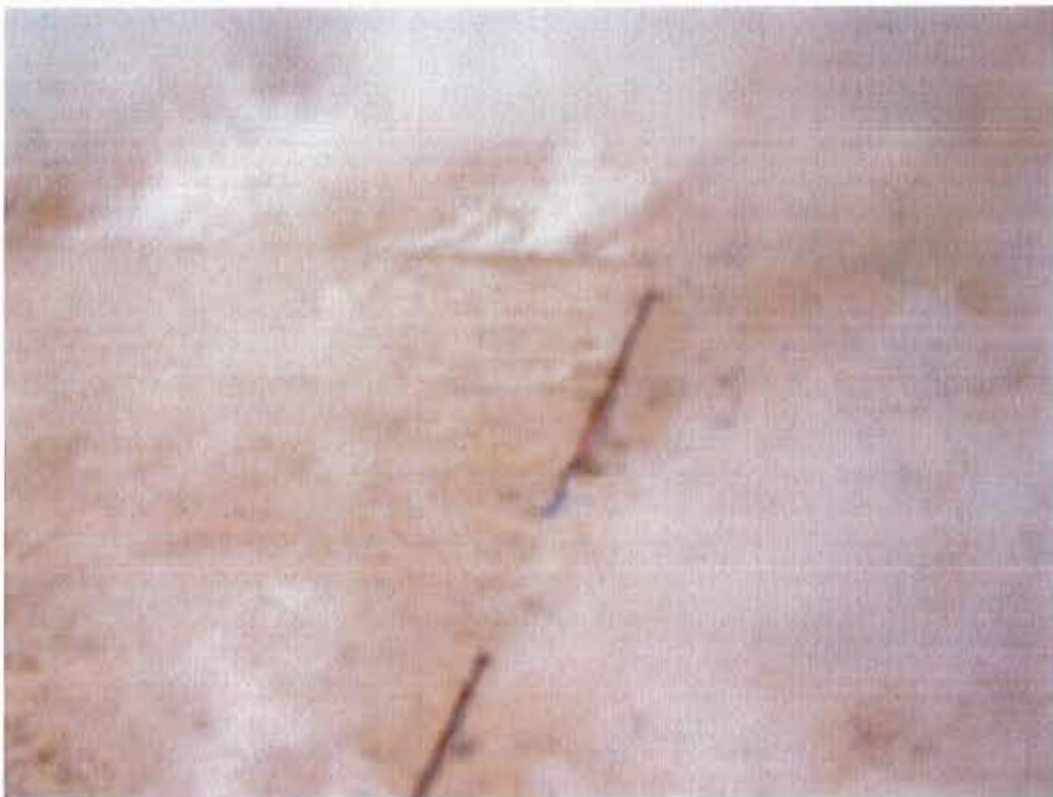
Vue de détail d'un joint en face non exposée à 26 minutes d'essai
