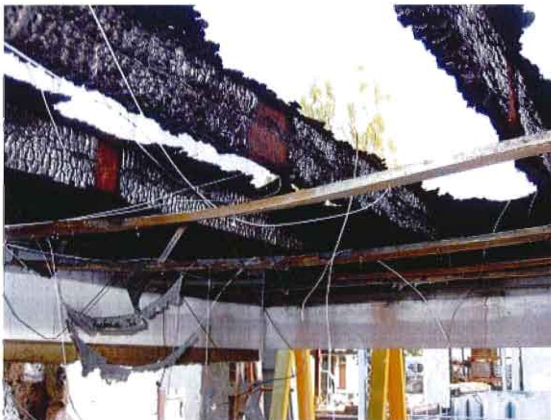
Vue de détail de la carbonisation des solives après la réalisation de l'essai
