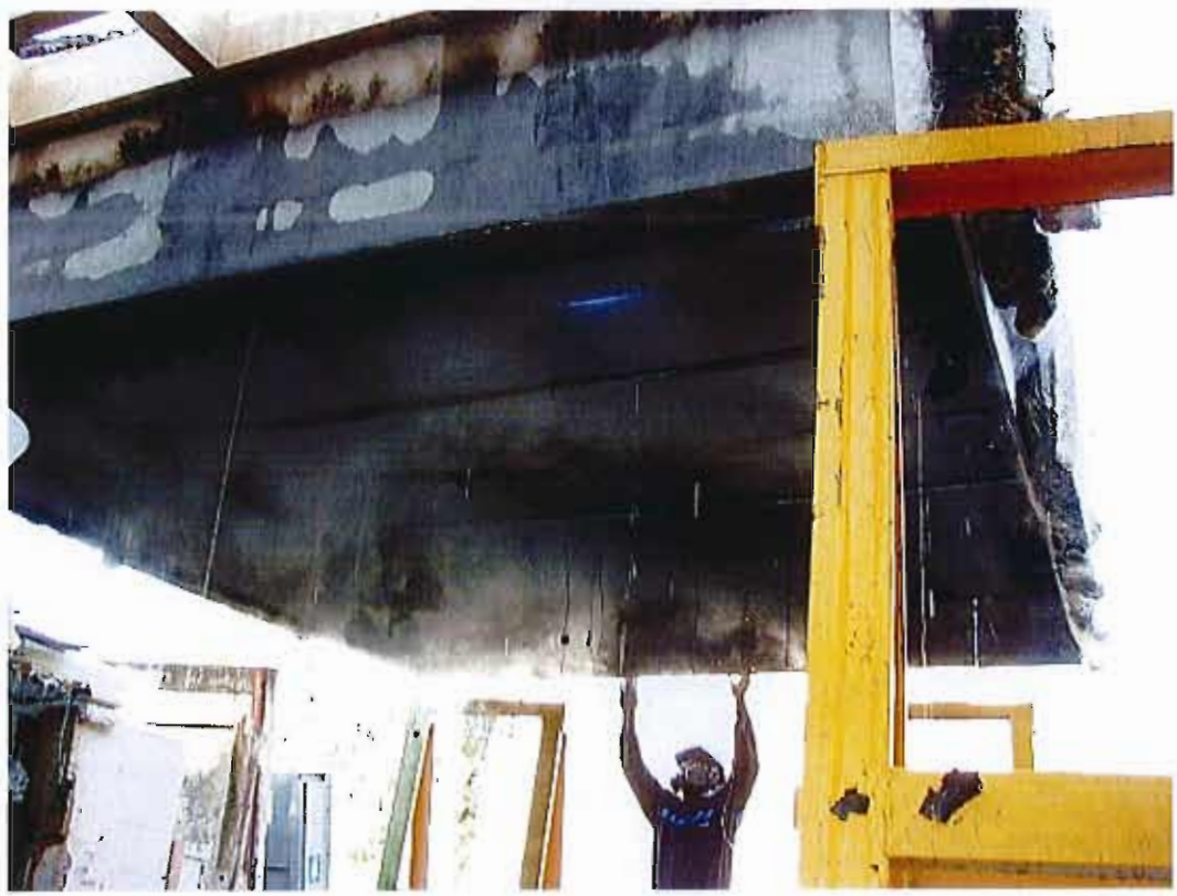
Vue de détail de la face exposée à la de la fin de l'arrosage
