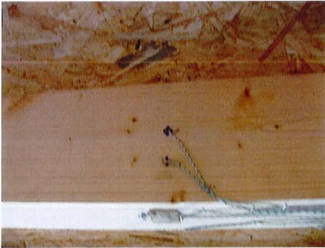
Vue de détail d'une solive du plancher de référence et de son instrumentation
