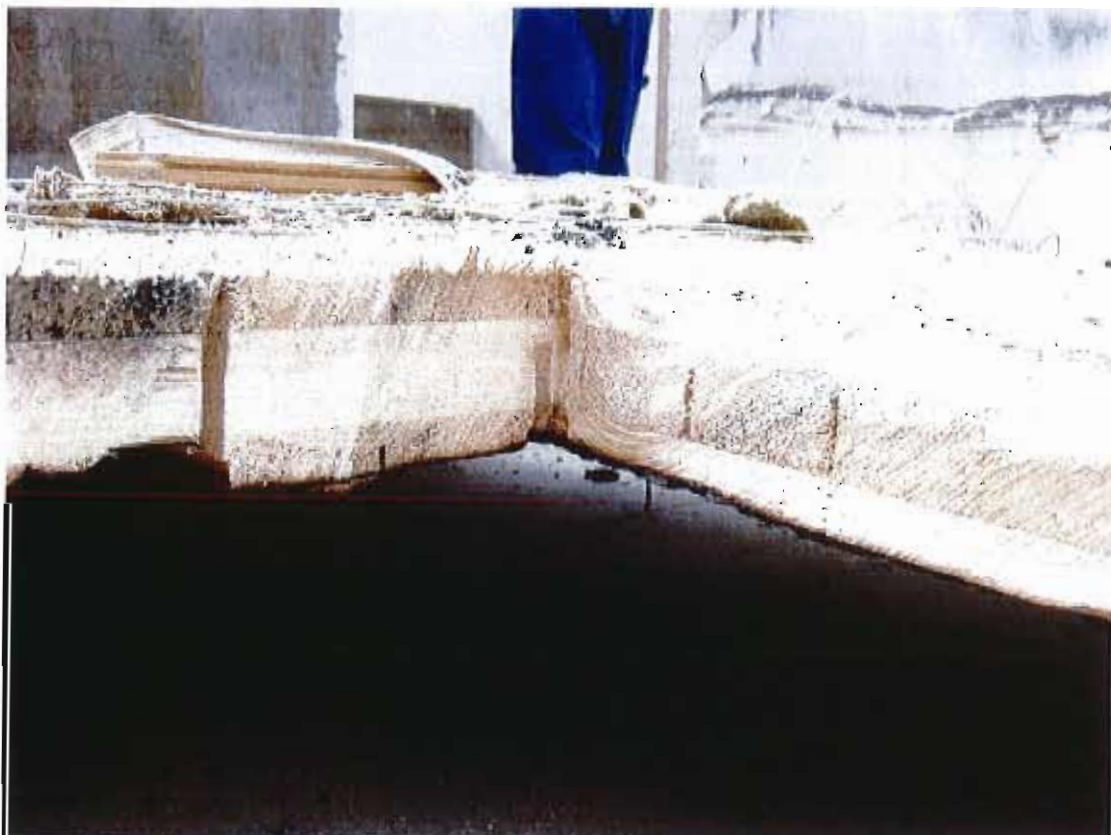
Vue de détail de l'épaisseur de bois sain au centre du plancher après la réalisation de l'essai
