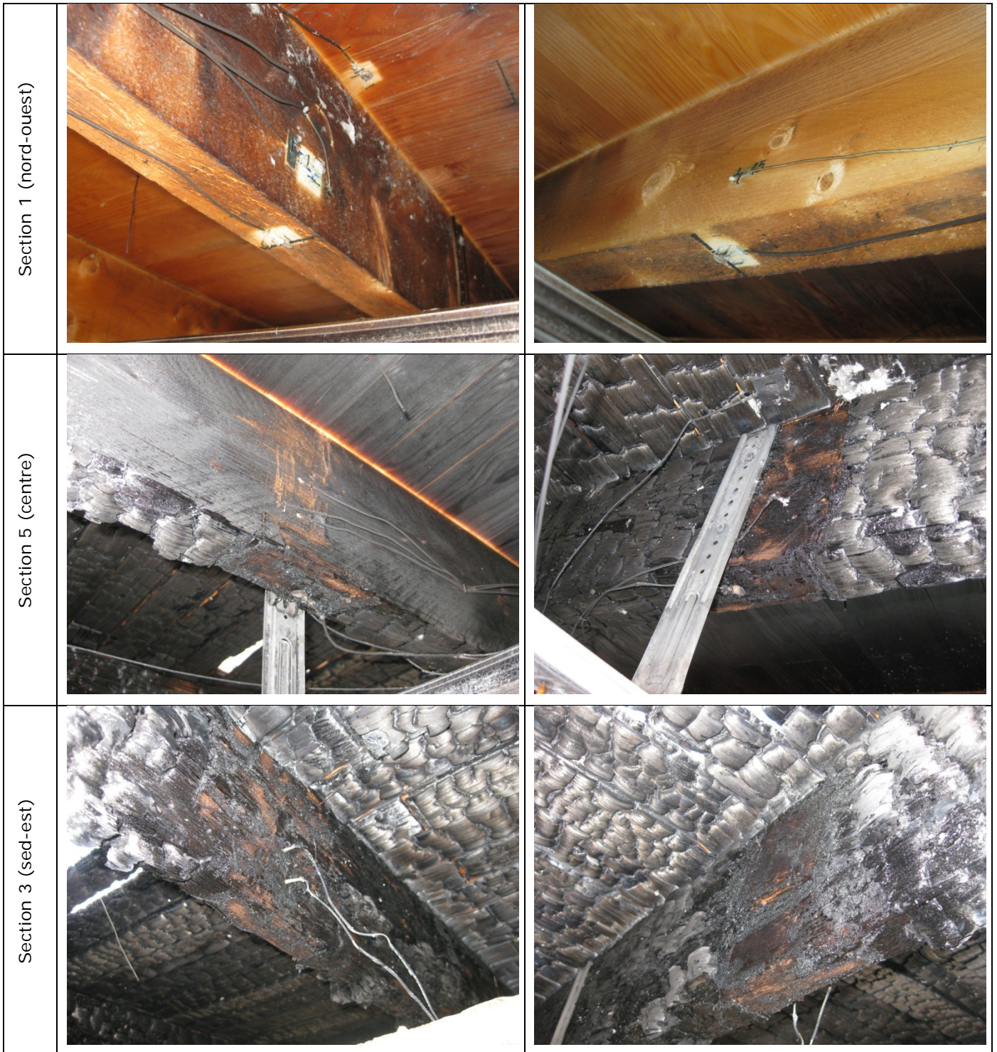
Figure 22 : Photographies des solives dans les sections 1, 5 et 3 après le refroidissement
