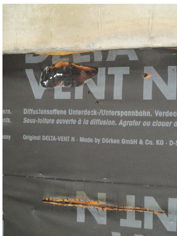
Vue d'ensemble des désordres repérés à mi-largeur et en partie supérieure de la cloison
