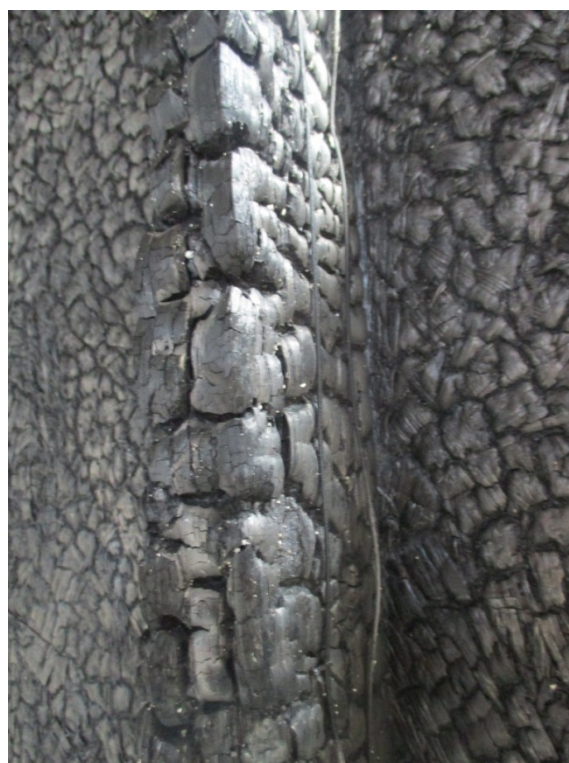
Détail de la carbonisation d'un montant de l'ossature de la cloison
