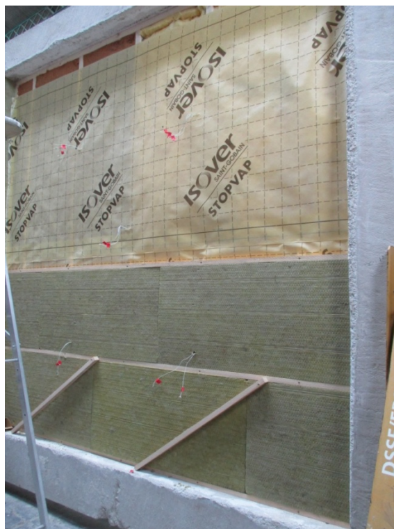
Mise en œuvre de l'isolation intérieure et de la contre-ossature intérieure de la cloison
