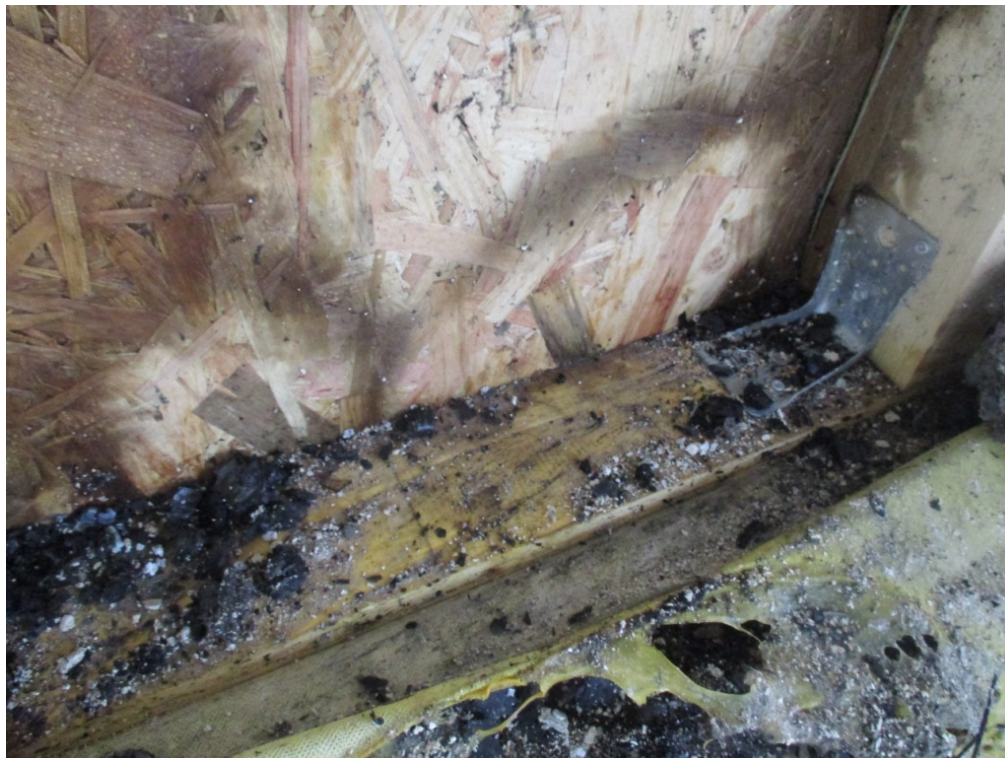
Détail de la carbonisation de la lisse basse de l'ossature de la cloison
