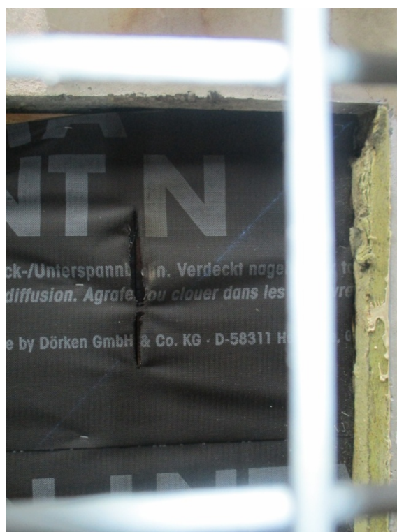
Vue d'ensemble du désordre repéré au droit du joint d'aboutage côté bord libre
