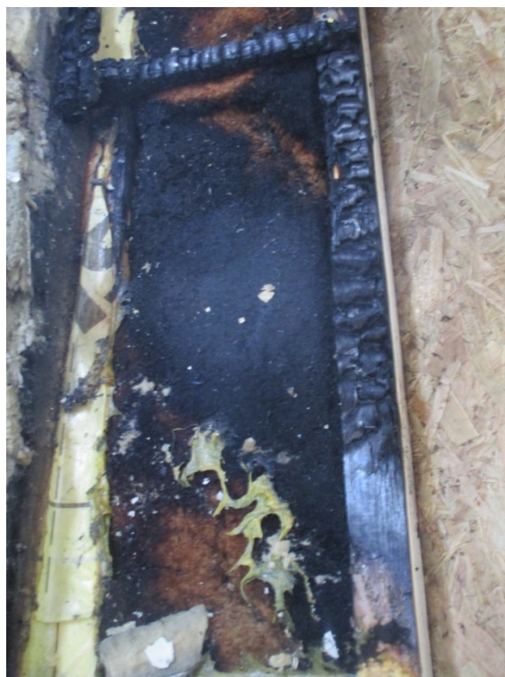
Détail de l'isolation restant côté bord libre
