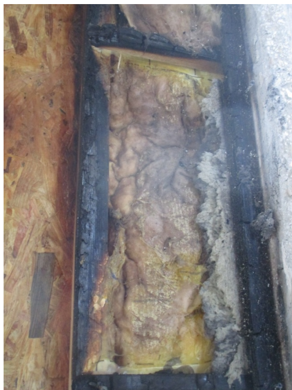
Détail de l'isolation restant côté bord fixe
