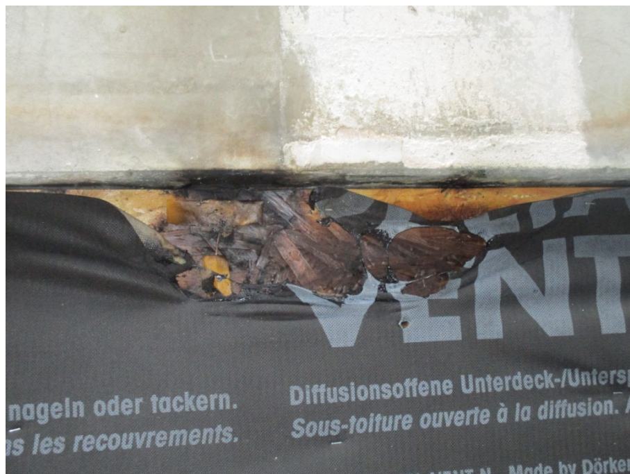
Vue d'ensemble du désordre repéré en lisse haute à environ ¼ de la largeur de la cloison
