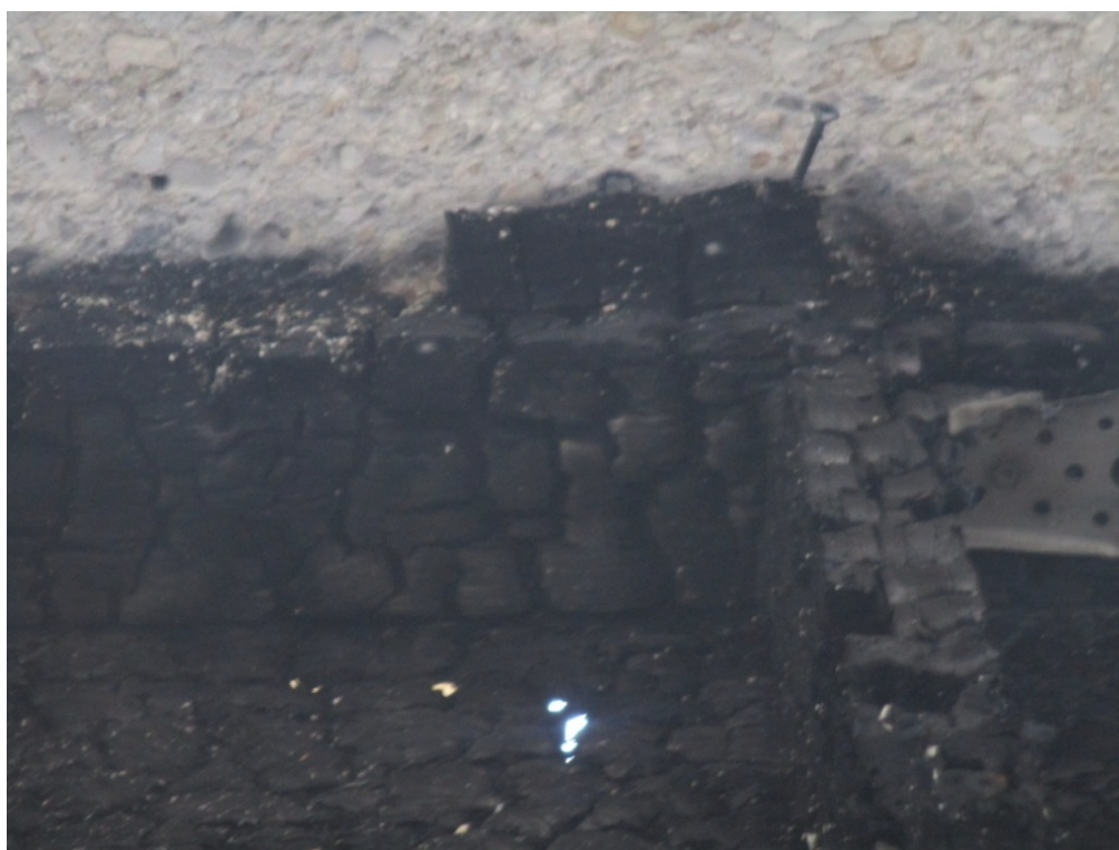
Détail de la carbonisation de la lisse haute de l'ossature de la cloison
