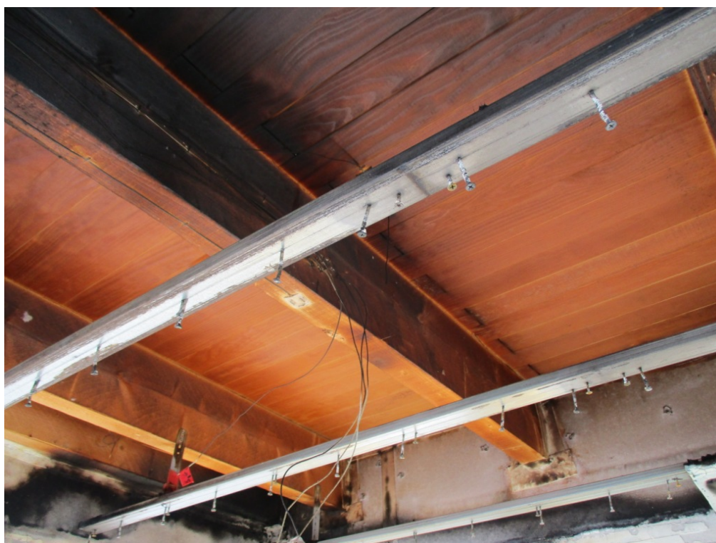
Détail de la zone non carbonisée en sous face du plancher
