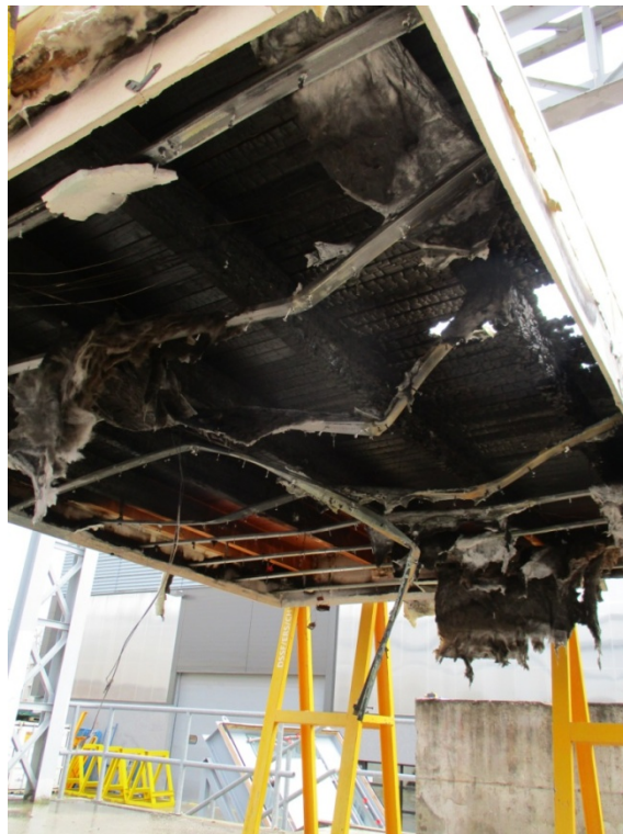
Vue d'ensemble de la face exposée après refroidissement
