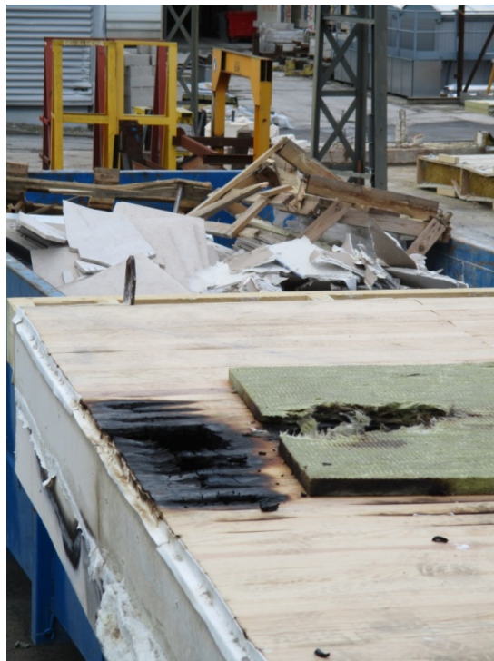
Détail de la zone carbonisée au droit du percement
