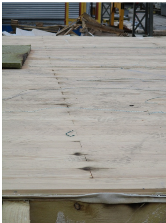
Vue d'ensemble du noircissement au droit des joints d'assemblage des lames de parquet
