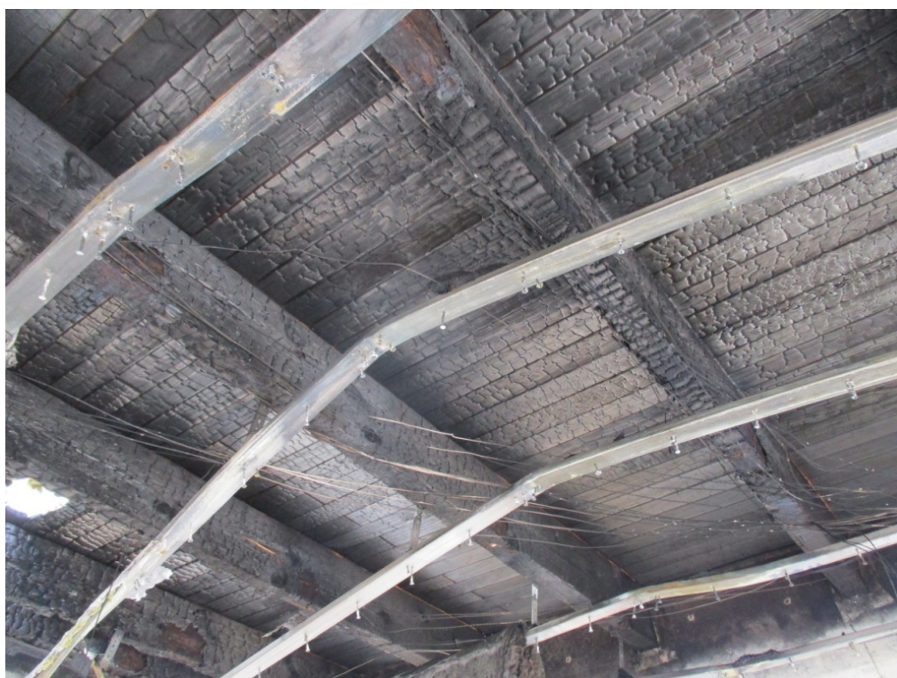
Détail de la zone carbonisée en sous-face du plancher
