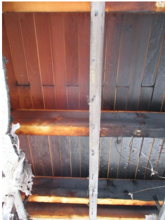
Détail du brunissement en sous-face du plancher
