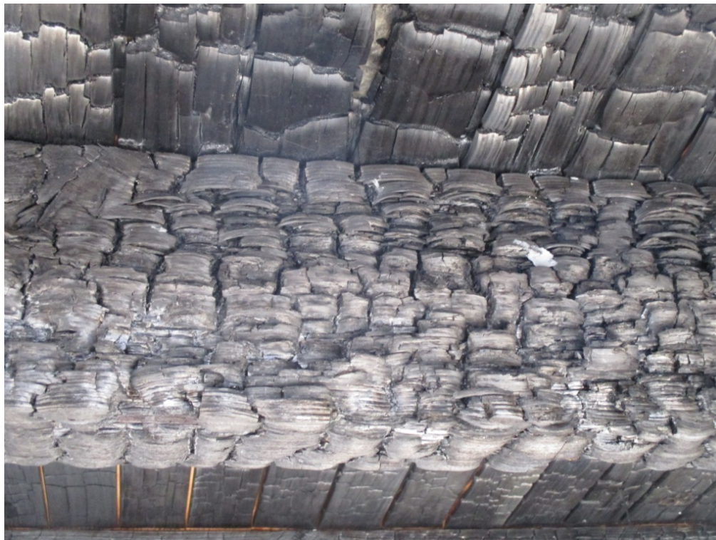
Détail de la carbonisation des solives du plancher
