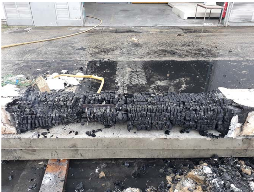
Figure A5.17 : Campagne 2 – Configuration 3 – Assemblage après essai
