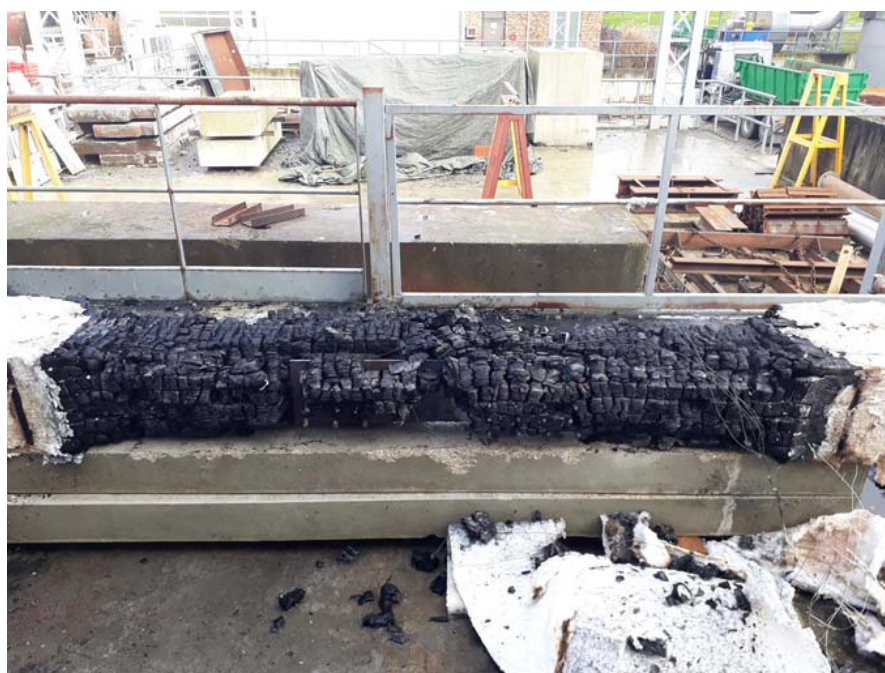
Figure A5.16 : Campagne 2 – Configuration 3 – Assemblage après essai
