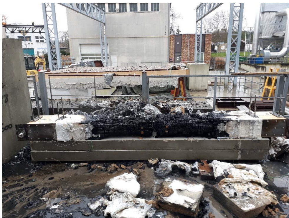
Figure A5.8 : Campagne 1 – Configuration 1' – Assemblage après essai
