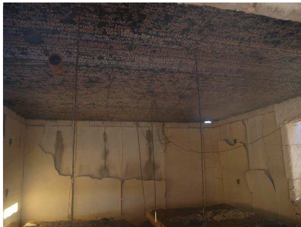
Figure 5-7 : Fin de l'Essai 2 (fin de combustion des bûchers et auto-extinction du plafond CLT MUF)
