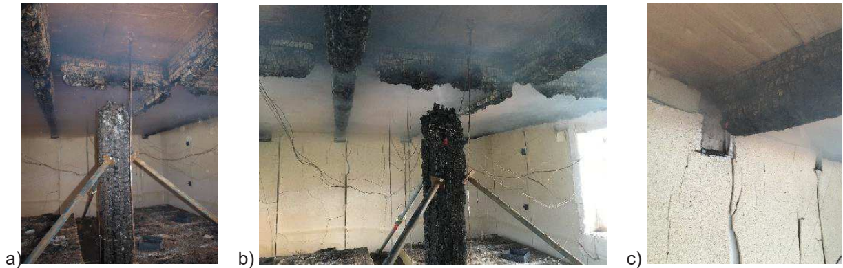
Figure E-43 : Vues de l'état des poutres et du poteau en BLC le lendemain de l'essai 3 a) interface entretoise/poteau ; b) interface solives/entretoises ; c) interface solive/paroi Nord
