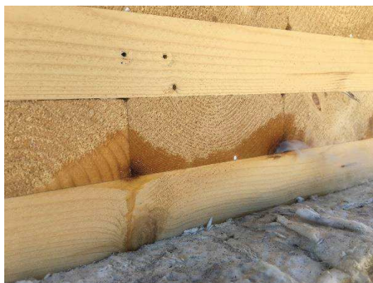
Figure 5-8 : Sortie de vapeur d'eau par les chanfreins des panneaux CLT en façade Nord (Essai 2)
