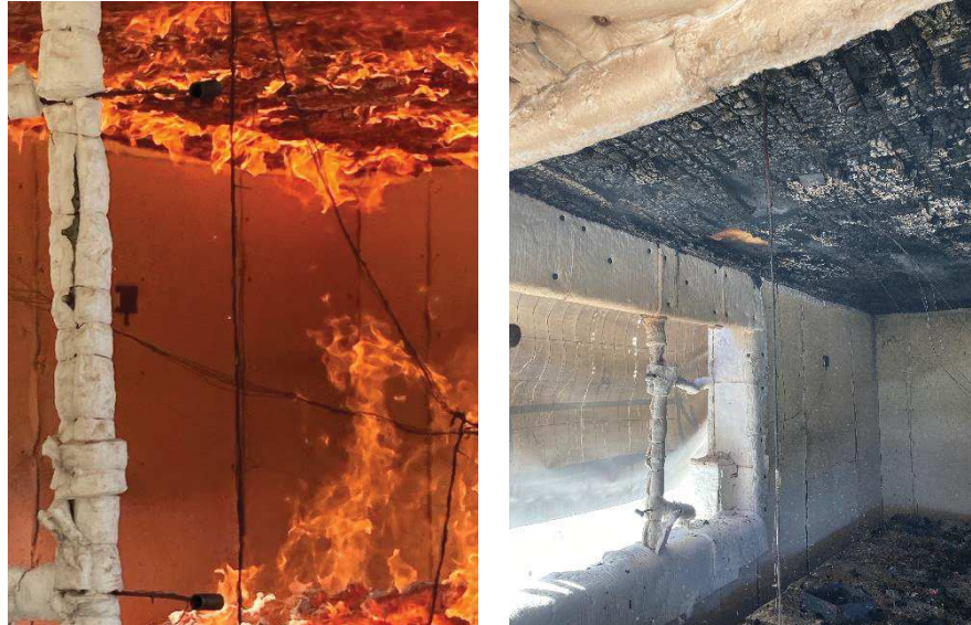
Figure 7-6 : Phénomènes de délamination lors de l'essai 4 a) pendant le feu généralisé b) après essai
