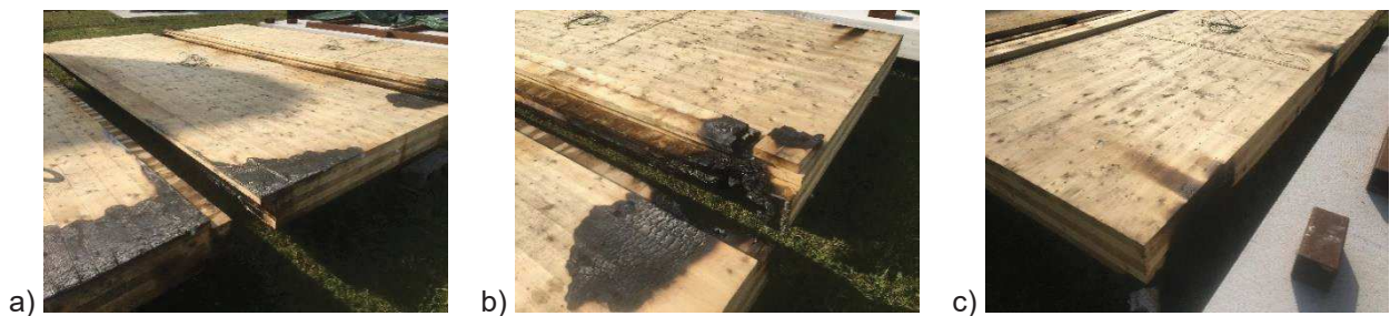
Figure E-40 : Vues extérieures du percement du plafond CLT le lendemain de l'essai 2 a) au-dessus de l'ouverture Est ; b) feuillures Nord-Est ; c) Coin Nord-Est
