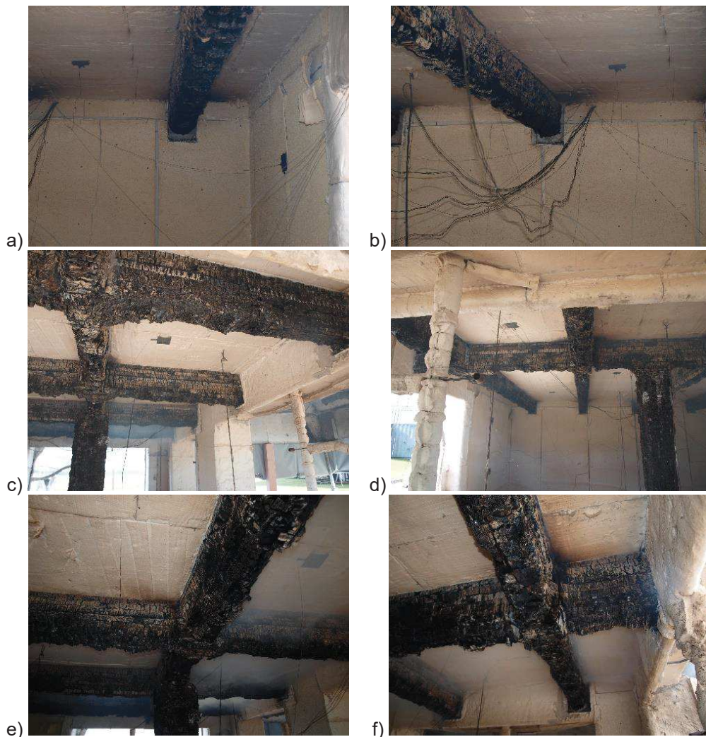
Figure E-42 : Vues de l'état des poutres et du poteau en BLC le soir de l'essai 3 ( t_{fin}+3h ) a) interface solive/paroi Nord côté Est ; b) interface solive/paroi Nord côté Ouest ; c) interface solives/paroi Sud d) interface entretoise/poteau ; e) et f) détails interface entretoises/solives
