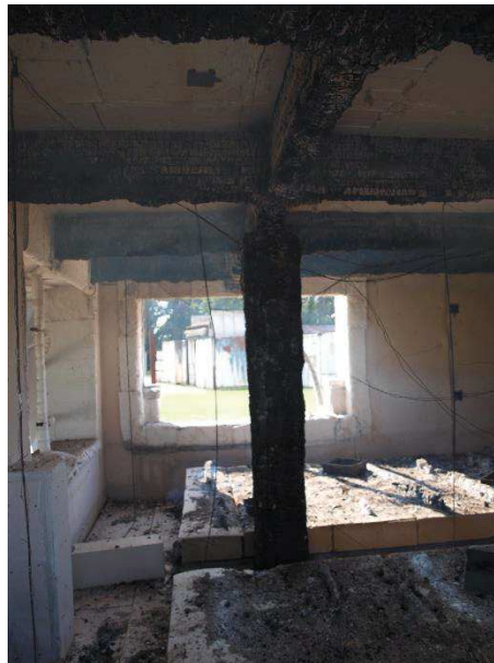
Figure 6-6 : Fin de l'Essai 3 (fin de combustion des bûchers et auto-extinction des poutres/poteau BLC)
