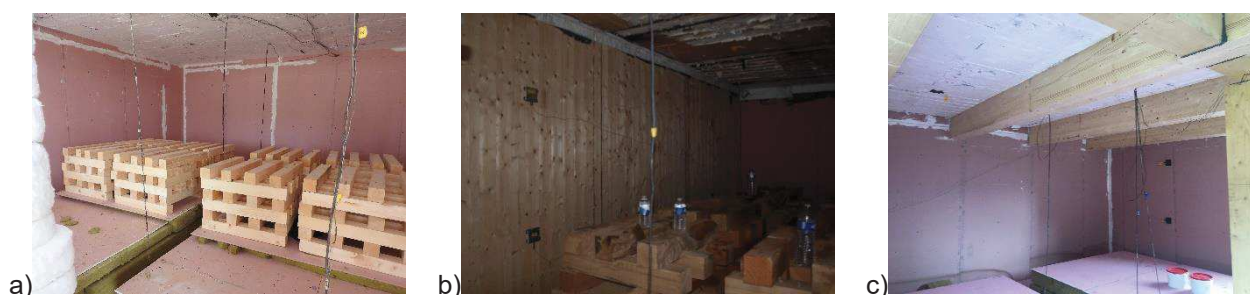
Figure 2-17 : Illustrations de la mise en place des perches de thermocouples a) Essai 0 ; b) Essai 1 ; c) Essai 3
