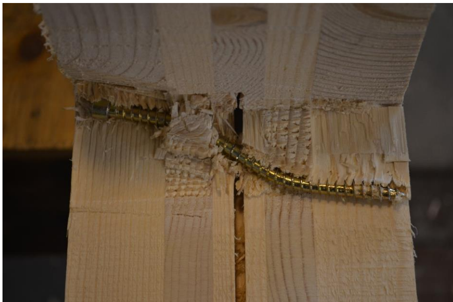
Figure 2-27 : Mode de rupture des assemblages de la configuration CIS-9-1
