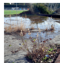
Absence d'entretien de toiture terrasse.
