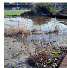
Absence d'entretien de toiture terrasse.
