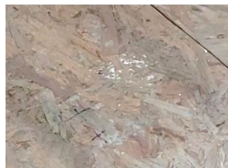
Photo 1 Décohésion de surface de panneau OSB
