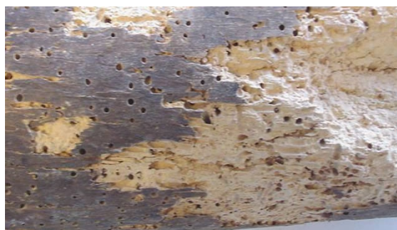
Photo 7 Dégâts de petite vrillette
