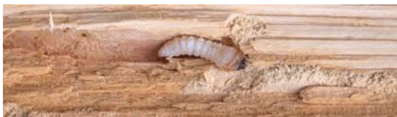
Photo 6 Dégâts et larve de capricorne des maisons
